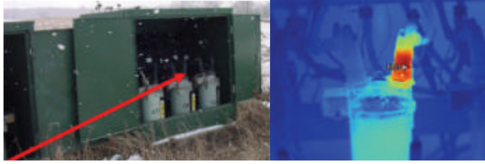
Yardımcı tesisler Bağlantının dirsek bölgesinde asiri sıcak yerin tespiti
